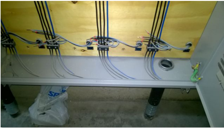
Entrada de energia inacabada.
